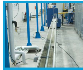
1RES CUVES DE REFROIDISSEMENT
